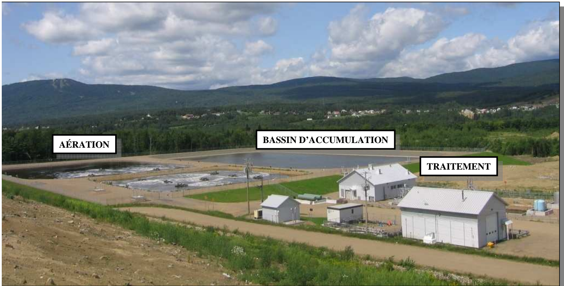
STATION DE TRAITEMENT DES EAUX DE LIXIVIATION
