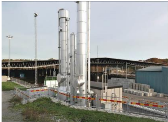
Biomethane plant of Malmberg/Västblekinge Miljö AB in Mörrum, Sweden
