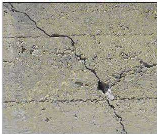
Figur 5-6 Spricka orsakad av frostangrepp (Inc, 2019)
