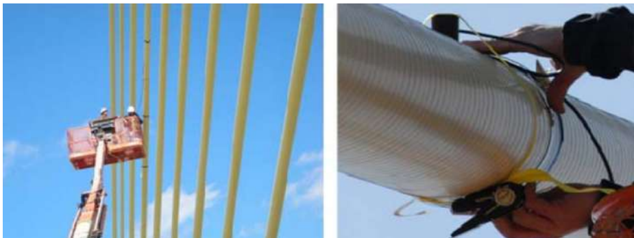
Figur 10-8 Installation av sensorerna (Parmar & Sharp, 2010)
