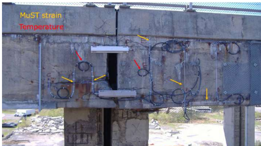
Figur 9-14 Exempel på montering av MuST-system för sprickövervakning (Brown, u.å)
