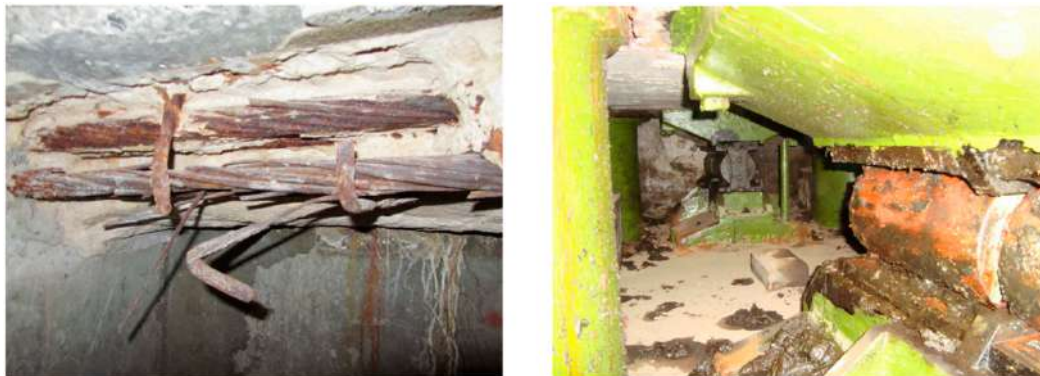
Figur 10-16 Korrosion på spännarmering och lager
