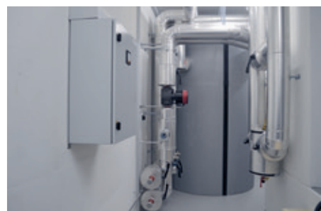
Einer der beiden Warmwasserspeicher mit einem Fassungsvermögen von je 5000 Liter mit den zwei Anschlüssen für eine Noteinspeisung und vorbereitete Erweiterung der Fernwärmleitung für die zweite Etappe Flurweg.
