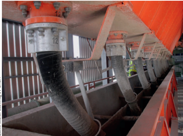
25 Auslaufdüsen des Freifallklassierers von AKW Discharge nozzles of the AKW freefall classifier
