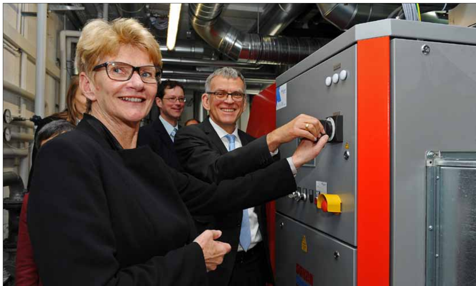
Oberbürgermeisterin Angelika Matt-Heidecker und Ministerialdirektor Helmfried Meinel nehmen symbolisch die neue Heizanlage des Kirchheimer Schlossgymnasiums in Betrieb. Das innovative Projekt spart nicht nur viel Geld, sondern reduziert auch den Schadstoffausstoß um über 80 Prozent. Foto: Markus Brändli
