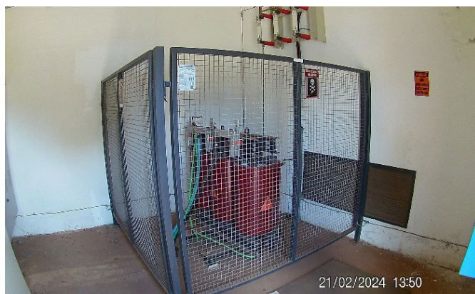
Subestação de Energia Elétrica
