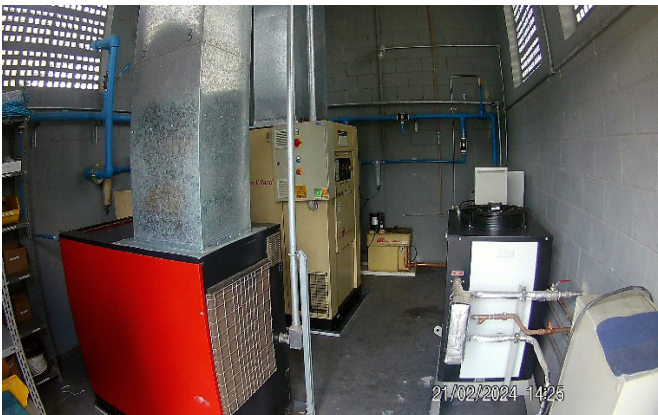
Sala de Compressores
