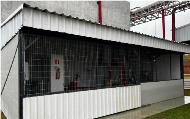
Casa de Bombas
