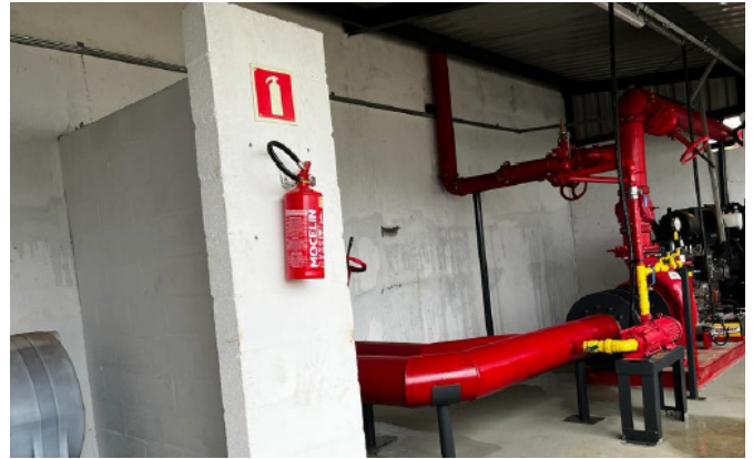
Casa de Bombas
