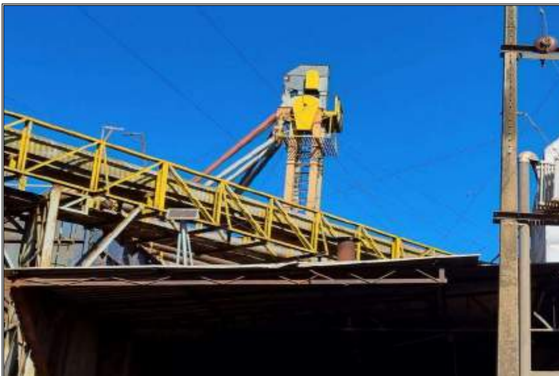
ITEM 1,016 - VISTA DO ELEVADOR DE CANECAS PLÁSTICA PARA CAPTAÇÃO DE GRÃOS DA MÁQUINA DE PRÉ LIMPEZA PARA O SECADORC CAP: 40 TON
