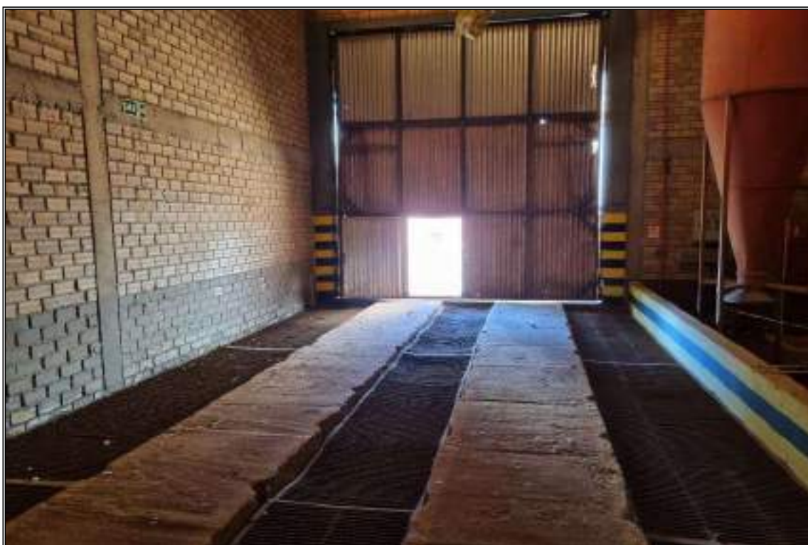
ITEM 2,002 - VISTA DA MOEGA DE DESCARGA DE GRÃOS COM ESTRUTURA EM CONCRETO CAP: 180 TON
