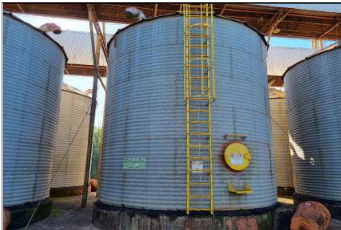
ITEM 2,010 - VISTA DO SILO DE ARMAZEMAGEM METÁLICO CAP: 90 TON COM VENTILADOR CENTRÍFUGO Nº 28
