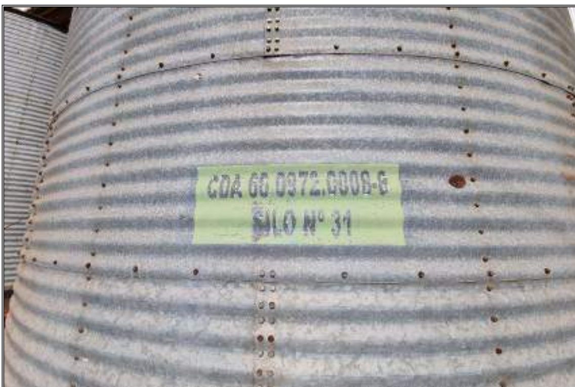
ITEM 2,013 - VISTA DA PLACA DE IDENTIFICAÇÃO DO SILO DE ARMAZEMAGEM METÁLICO CAP: 90 TON COM VENTILADOR CENTRÍFUGO Nº 31
