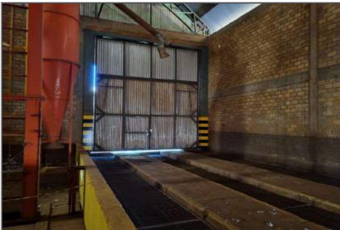
ITEM 2,003 - VISTA DA MOEGA DE DESCARGA DE GRÃOS COM ESTRUTURA EM CONCRETO CAP: 180 TON
