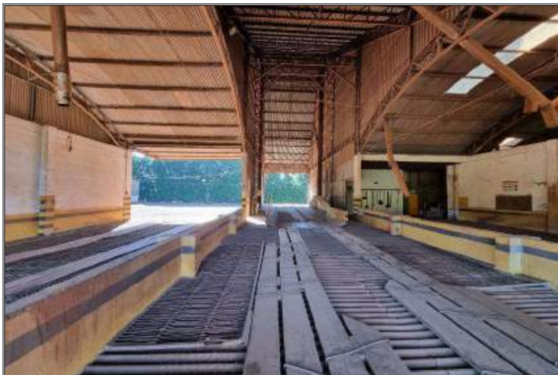
ITEM 1,004 - VISTA DA MOEGA DE DESCARGA DE GRÃOS COM ESTRUTURA EM CONCRETO CAP: 600 TON
