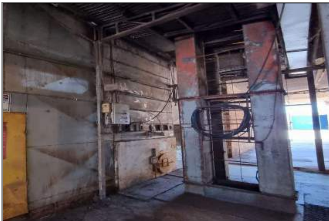
ITEM 1,022 - VISTA DO ELEVADOR DE CANECAS PLÁSTICA PARA CAPTAÇÃO DE GRÃOS DO SECADOR PARA TULHA DE EXPEDIÇÃO DE RESÍDUOS E SILO DE EXPEDIÇÃO
