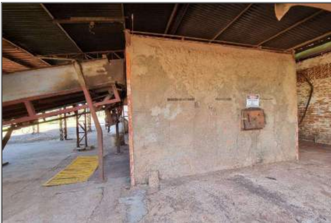
ITEM 1,020 - VISTA DA FORNALHA A LENHA DO SECADOR DE COLUNA COMPOSTA POR: TIJOLOS REFRAFATÁRIOS, ESTRUTURA METÁLICA, E SISTEMA DE CONTROLE DE TEMPERATURA
