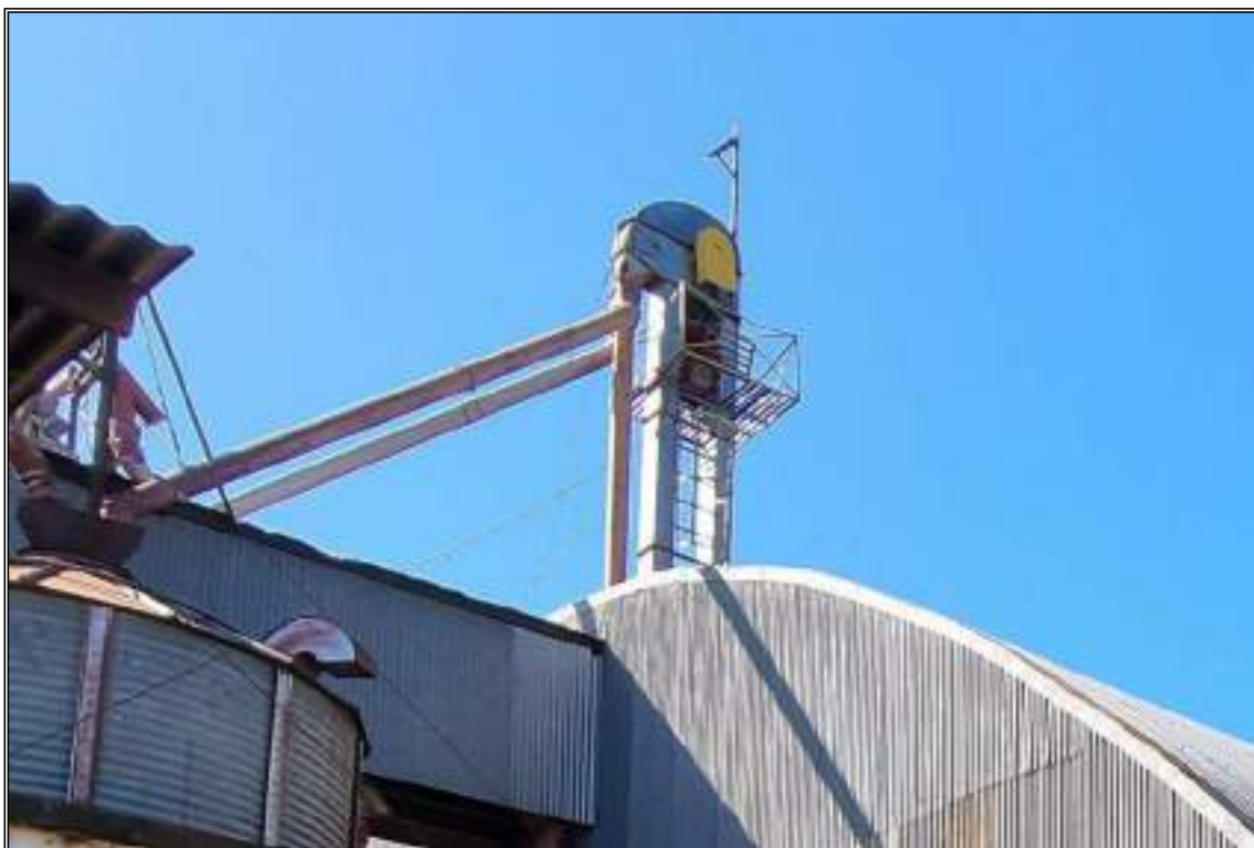
ITEM 1,029 - VISTA DO ELEVADOR DE CANECAS PLÁSTICA PARA CAPTAÇÃO DE GRÃOS DO SECADOR PARA O ARMAZEM
