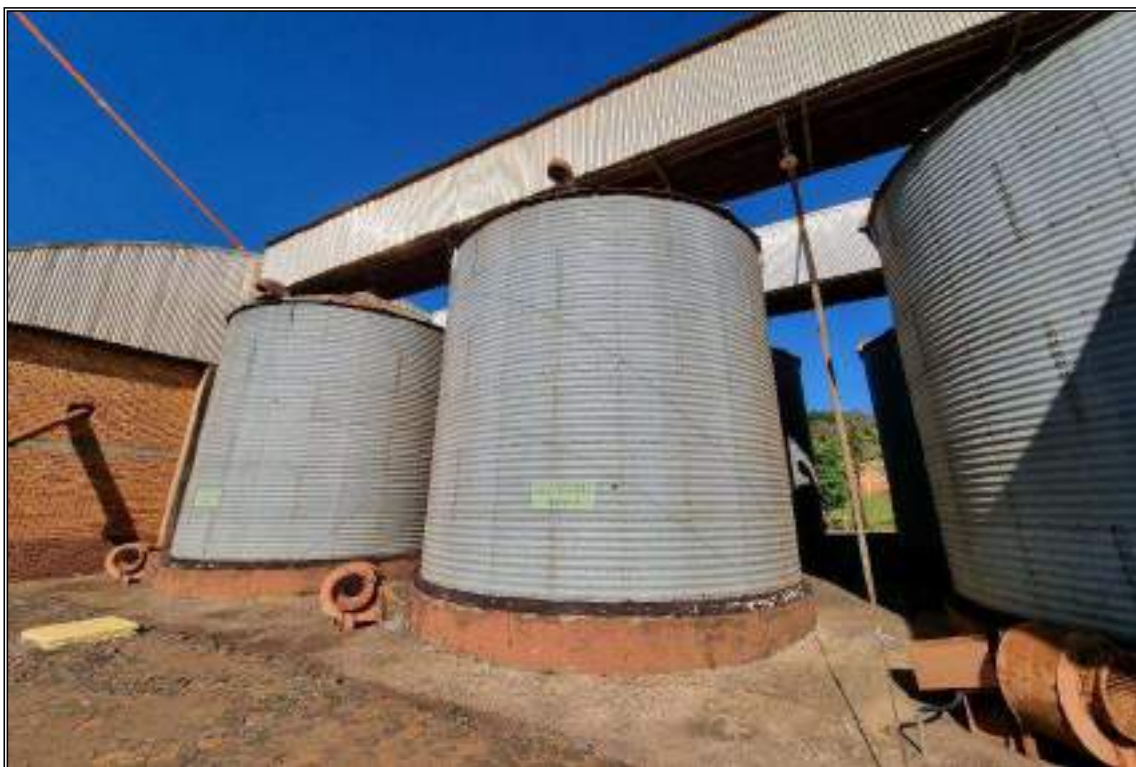
ITEM 2,013 - VISTA DO SILO DE ARMAZEMAGEM METÁLICO CAP: 90 TON COM VENTILADOR CENTRÍFUGO Nº 31
