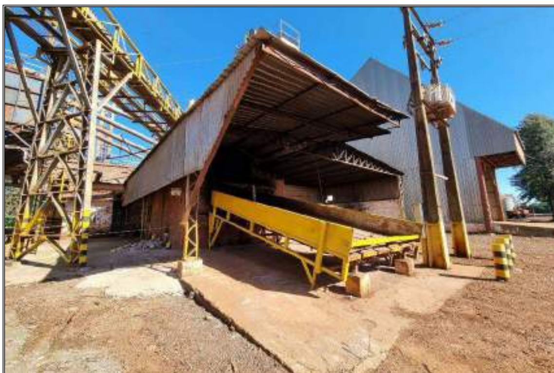
ITEM 1,018 - VISTA DA FORNALHA A LENHA DO SECADOR DE COLUNA COMPOSTA POR: TIJOLOS REFRACTÁRIOS, ESTRUTURA METÁLICA, E SISTEMA DE CONTROLE DE TEMPERATURA
