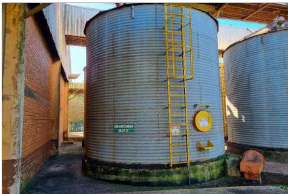
ITEM 2,009 - VISTA DO SILO DE ARMAZEMAGEM METÁLICO CAP: 90 TON COM VENTILADOR CENTRÍFUGO Nº 27
