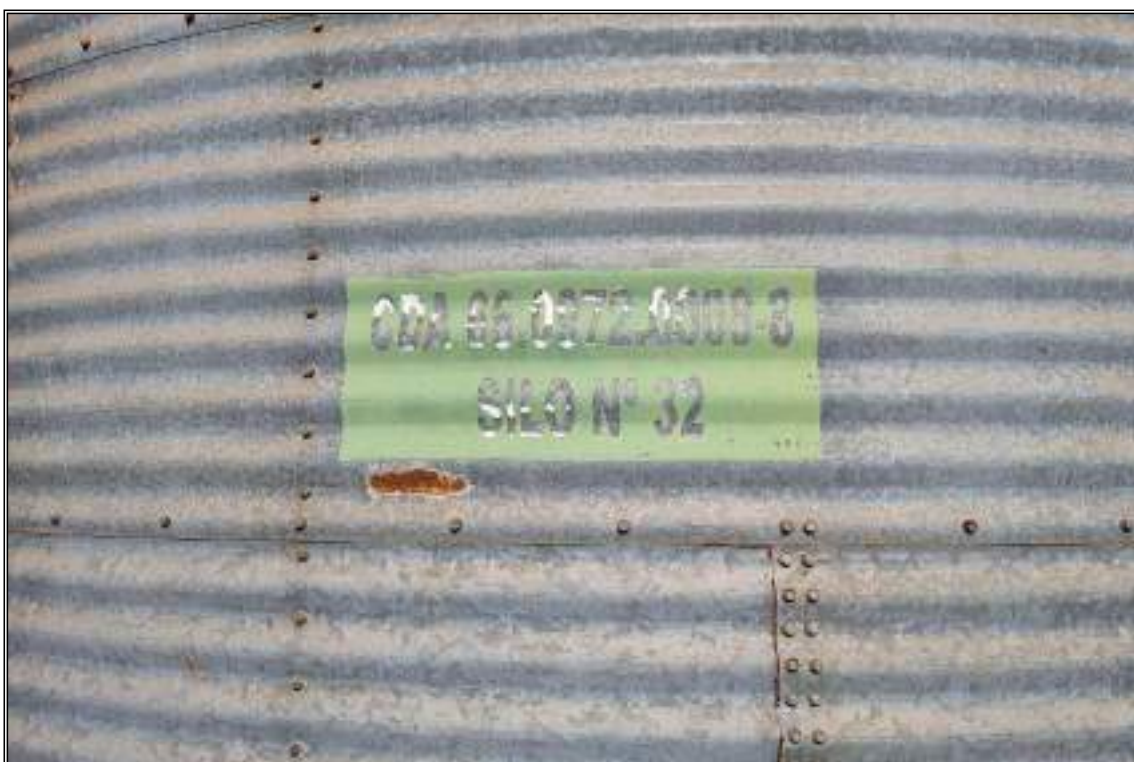
ITEM 2,014 - VISTA DA PLACA DE IDENTIFICAÇÃO DO SILO DE ARMAZEMAGEM METÁLICO CAP: 90 TON COM VENTILADOR CENTRÍFUGO Nº 32
