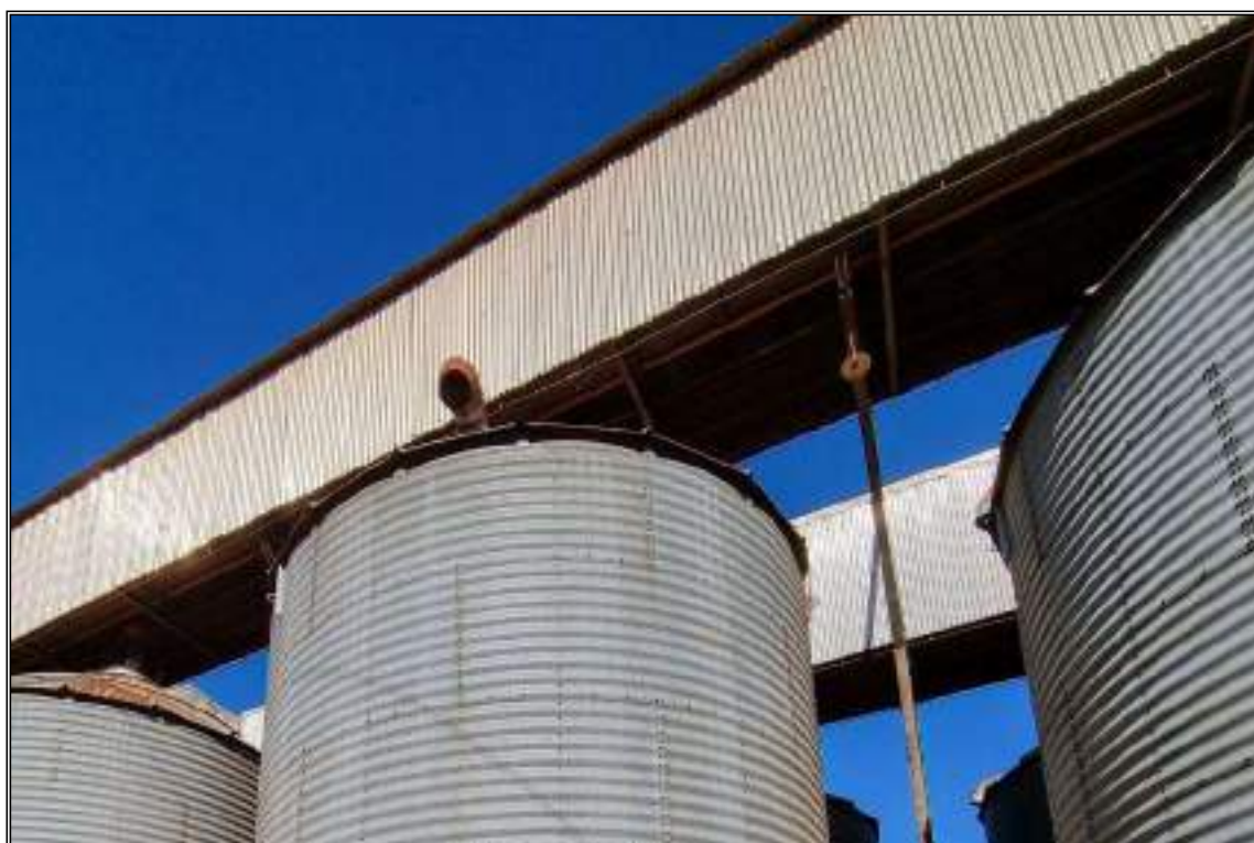
ITEM 2,008 - VISTA DA CORREIA TRANSPORTADORA SUPERIOR PARA CAPTAÇÃO DE GRÃOS DO ELEVADOR DE CANECAS PARA OS SILOS
