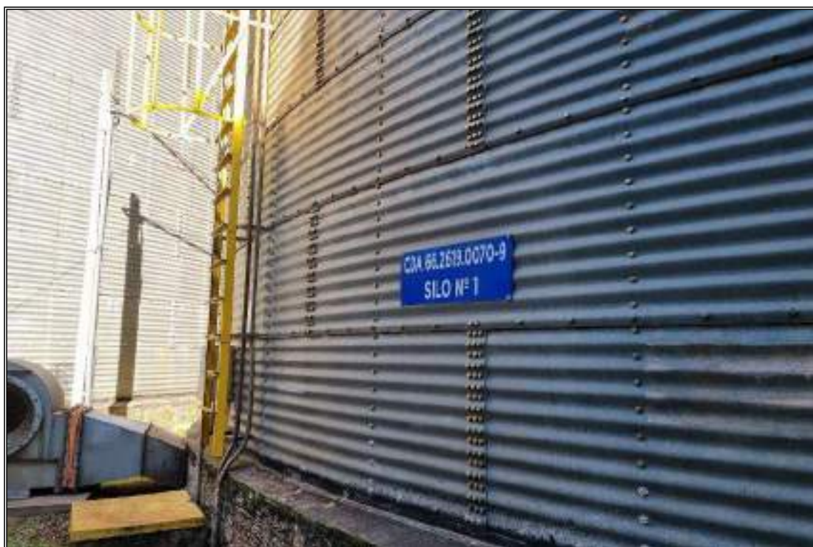
ITEM 1,033 - VISTA DA PLACA DE IDENTIFICAÇÃO DO SILO DE ARMAZEMAGEM METÁLICO Nº 1
