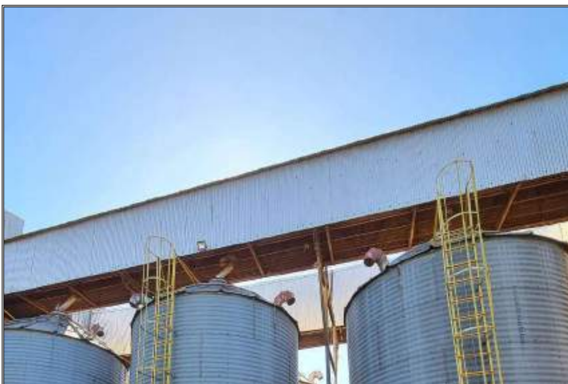
ITEM 2,017 - VISTA DA CORREIA TRANSPORTADORA SUPERIOR PARA CAPTAÇÃO DE GRÃOS DO ELEVADOR DE CANECAS PARA OS SILOS
