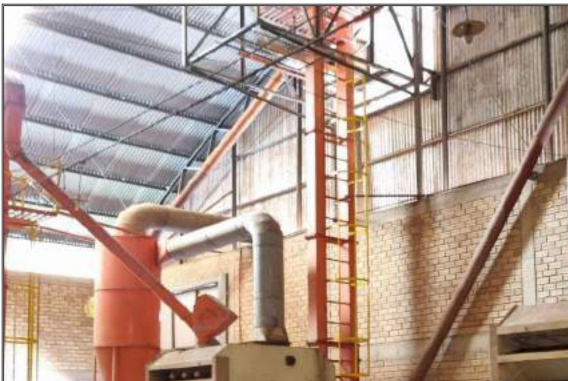
ITEM 2,004 - VISTA DO ELEVADOR DE CANECAS PLÁSTICA PARA CAPTAÇÃO DE GRÃOS DA MOEGA PARA A MÁQUINA DE PRÉ-LIMPEZA
