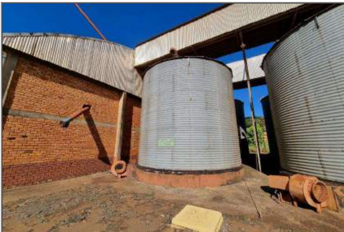
ITEM 2,014 - VISTA DO SILO DE ARMAZEMAGEM METÁLICO CAP: 90 TON COM VENTILADOR CENTRÍFUGO Nº 32
