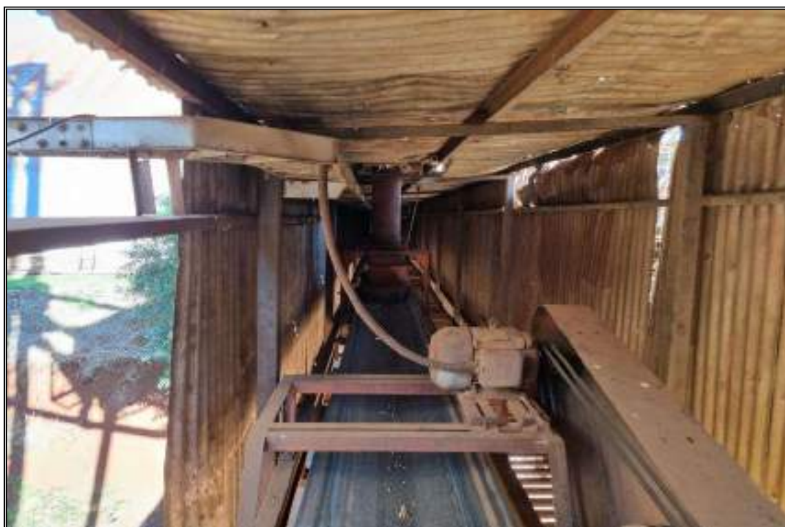
ITEM 1,028 - VISTA DA CORREIA TRANSPORTADORA PARA CAPTAÇÃO DE GRÃOS DO ELEVADOR DE CANECAS PARA O CARREGAMENTO
