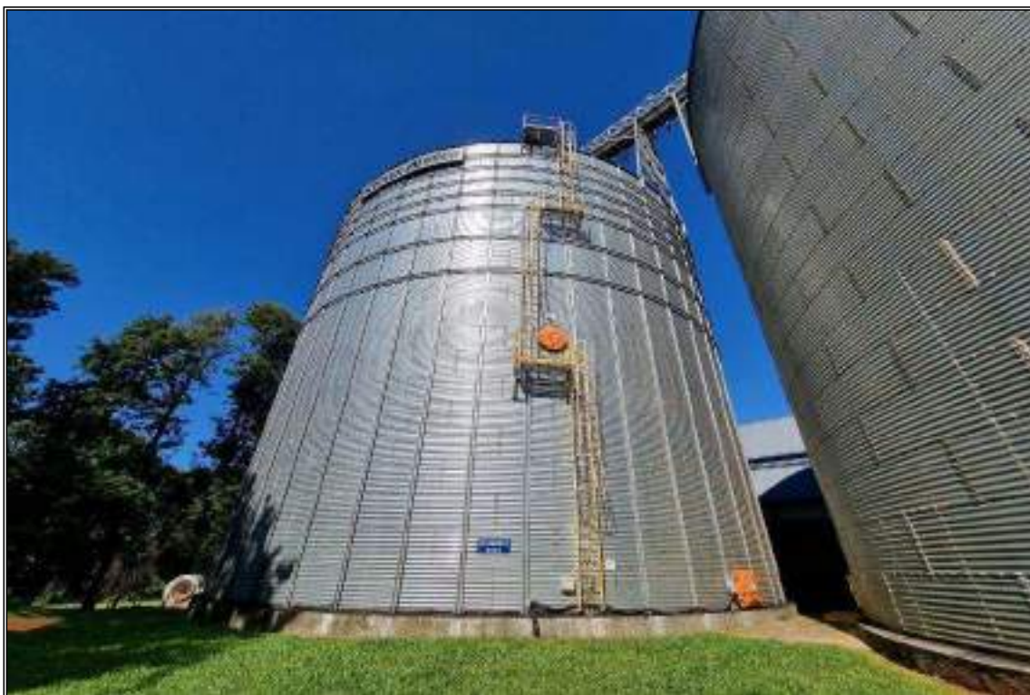
ITEM 1,035 - VISTA DO SILO DE ARMAZEMAGEM METÁLICO MARCA: KELPLER WEBER CAP: 6.000 COM VENTILADOR CENTRÍFUGO E SISTEMA DE TERMOMETRIA Nº 3
