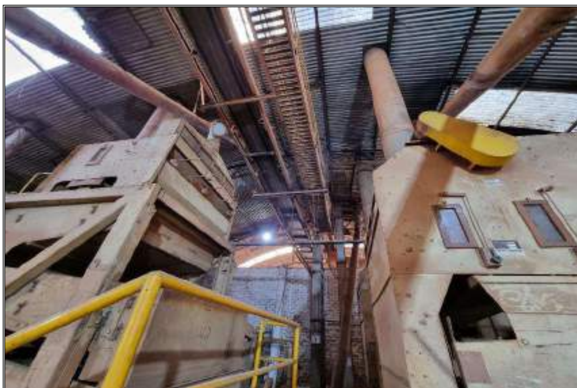
ITEM 1,009 - VISTA DA CORREIA TRANSPORTADORA SUPERIOR PARA TRANSPORTE DO ELEVADOR DE CANECA PARA MÁQUINA DE PRÉ-LIMPEZA
