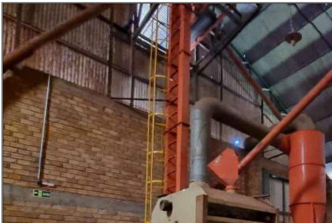
ITEM 2,006 - VISTA DO ELEVADOR DE CANECAS PLÁSTICA PARA CAPTAÇÃO DE GRÃOS DA MÁQUINA DE PRÉ-LIMPEZA PARA CORREIA TRANSPORTADORA E SILO DE EXPEDIÇÃO
