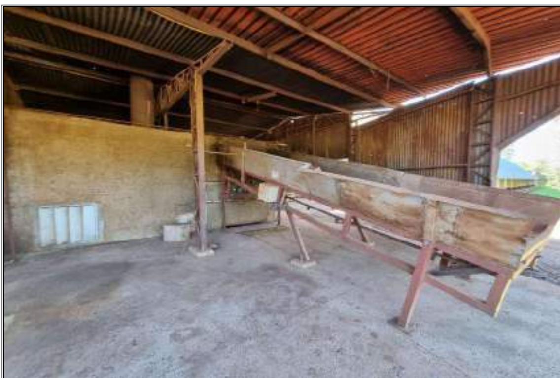
ITEM 1,020 - VISTA DA FORNALHA A LENHA DO SECADOR DE COLUNA COMPOSTA POR: TIJOLOS REFRAATÓRIOS, ESTRUTURA METÁLICA, E SISTEMA DE CONTROLE DE TEMPERATURA
