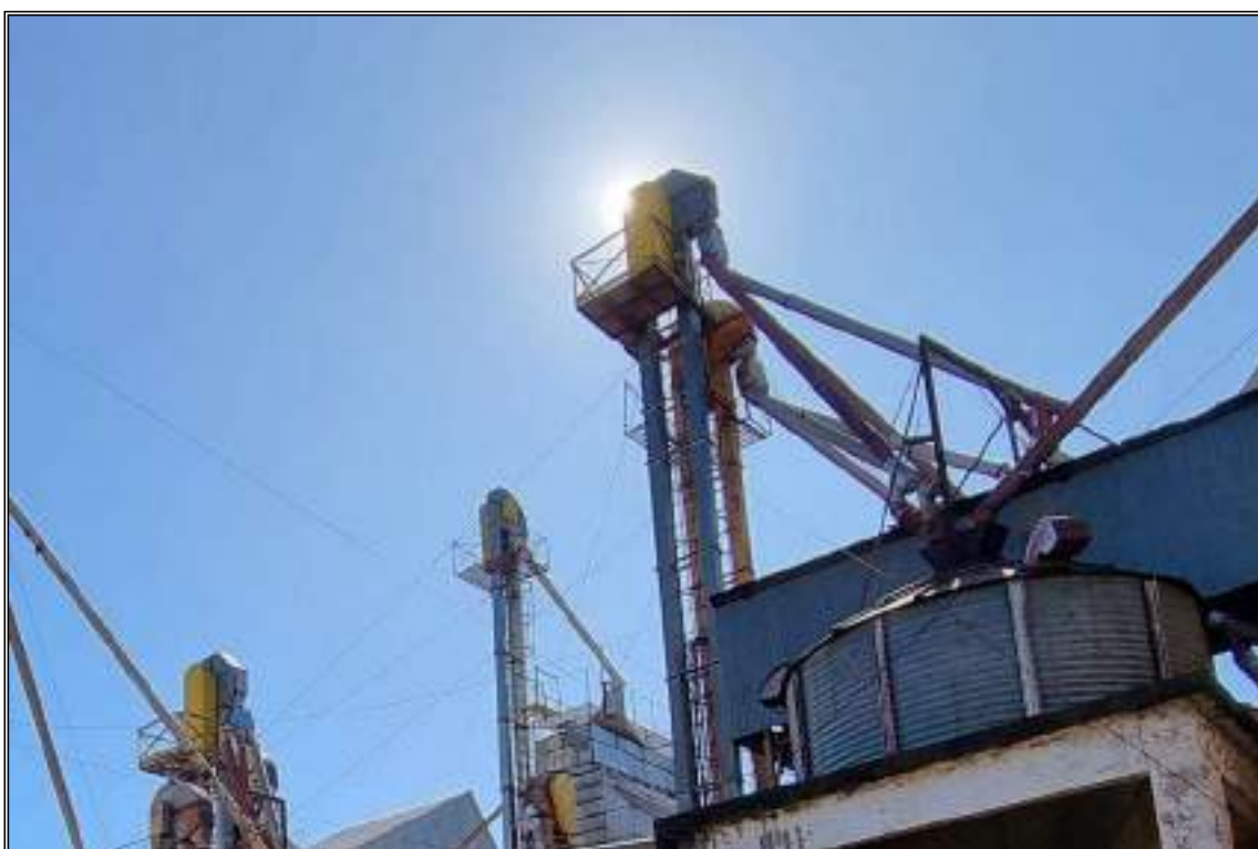
ITEM 1,015 - VISTA DO ELEVADOR DE CANECAS PLÁSTICA PARA CAPTAÇÃO DE GRÃOS DA MÁQUINA DE PRÉ-LIMPEZA PARA O SECADOR CAP: 60 TON
