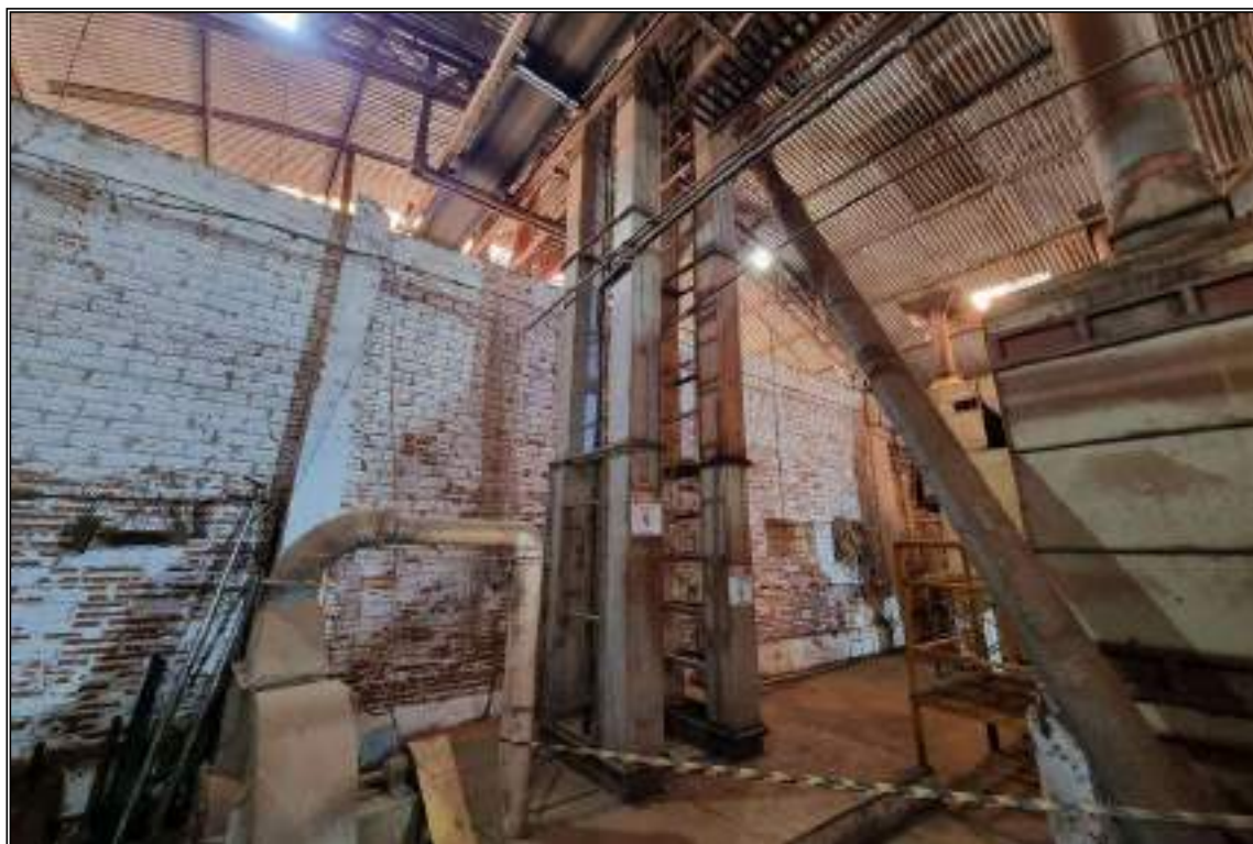
ITEM 1,007 / ITEM 1,008 - VISTA DO ELEVADOR DE CANECAS PLÁSTICA PARA CAPTAÇÃO DE GRÃOS DA MOEGA PARA A MÁQUINA DE PRÉ-LIMPEZA
