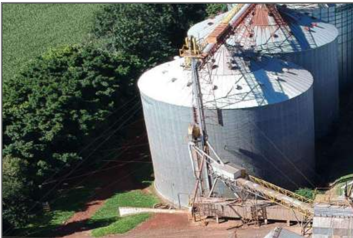
ITEM 1,031 - VISTA DO ELEVADOR DE CANECAS PLÁSTICA PARA CAPTAÇÃO DE GRÃOS DA CORREIA TRANSPORTADORA INFEIOR PARA A CORREIA TRANSPORTADORA SUPERIOR DOS SILOS
