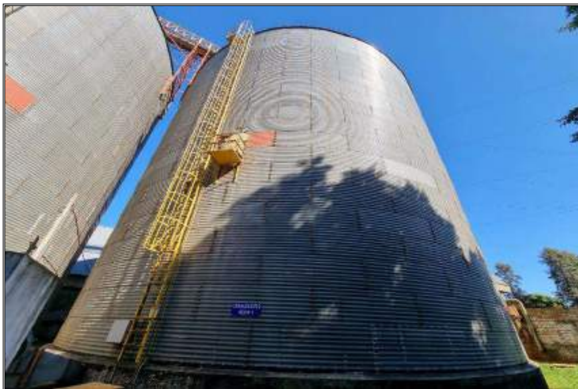
ITEM 1,033 - VISTA DO SILO DE ARMAZEMAGEM METÁLICO MARCA: KELPLER WEBER CAP: 6.000 COM VENTILADOR CENTRÍFUGO E SISTEMA DE TERMOMETRIA Nº 1
