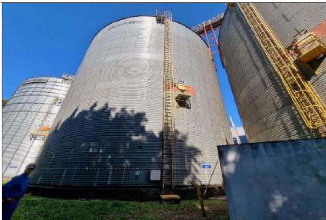
ITEM 1,034 - VISTA DO SILO DE ARMAZEMAGEM METÁLICO MARCA: KELPLER WEBER CAP: 6.000 COM VENTILADOR CENTRÍFUGO E SISTEMA DE TERMOMETRIA Nº 2
