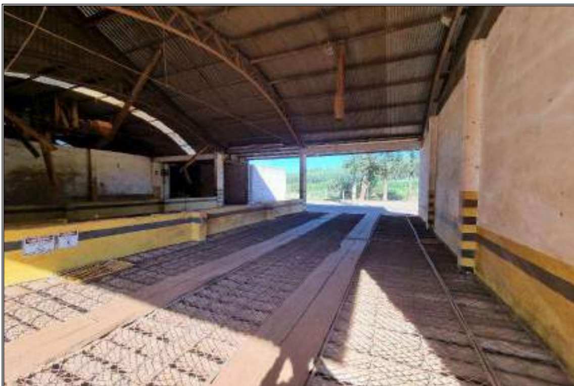
ITEM 1,003 - VISTA DA MOEGA DE DESCARGA DE GRÃOS COM ESTRUTURA EM CONCRETO CAP: 600 TON
