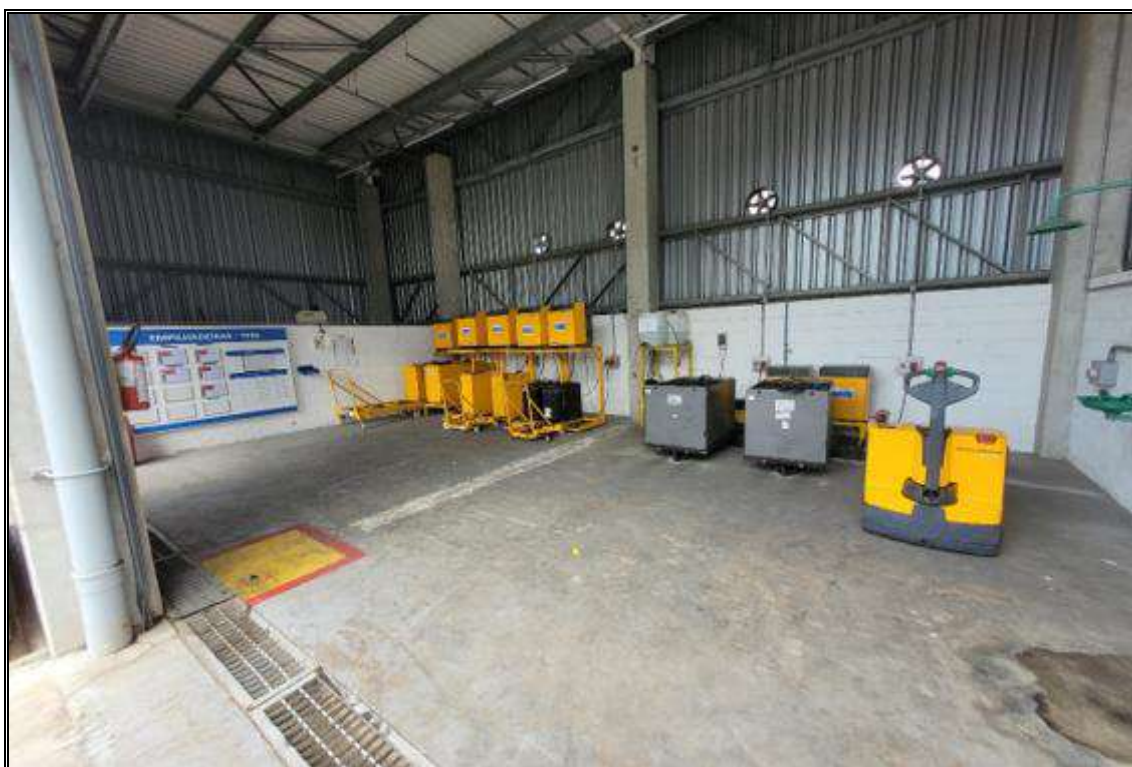
CENTRAL DE BATERIAS
