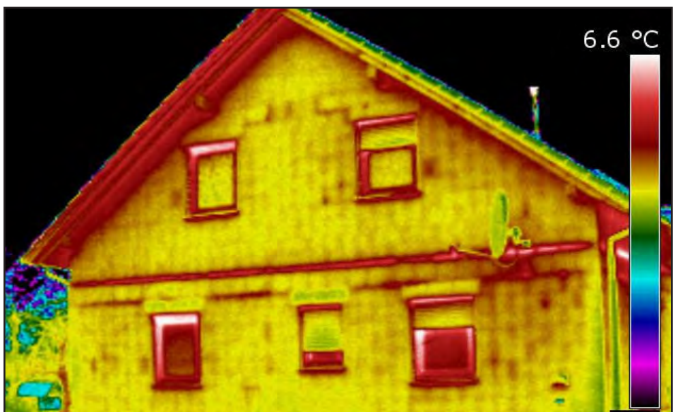
Abb. 8: Thermografieaufnahme mit Wärmebrücke im Deckenbereich (Quelle: INFRARO)
