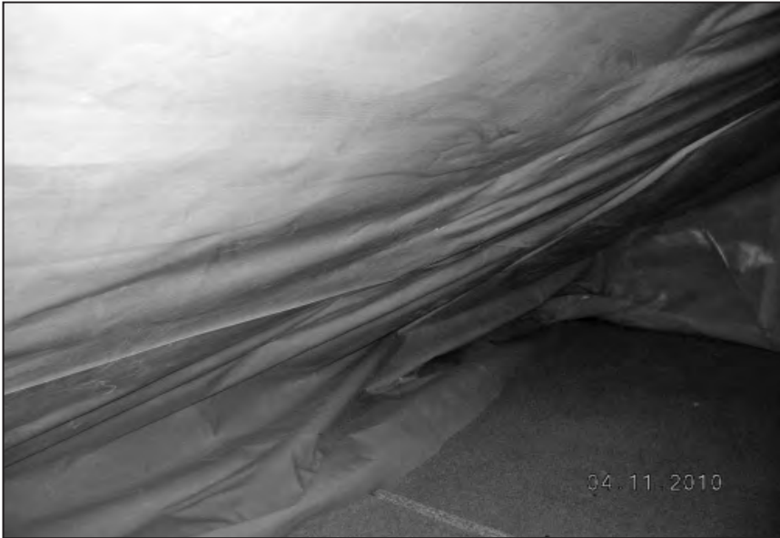
Abb.4: Locker verlegte „luftdichte Ebene“ im Spitzboden (Quelle: INFRARO)
