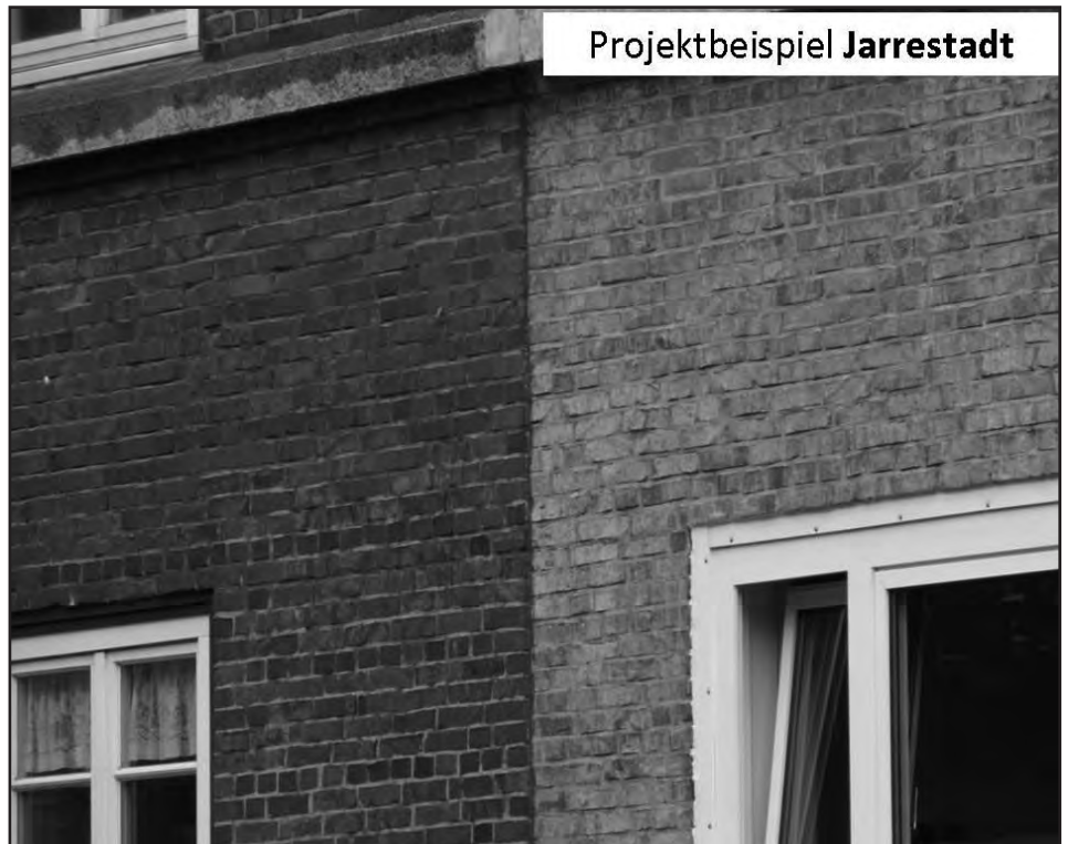
Abb. 7: Geschlammte und ungeschlammte Fassade
