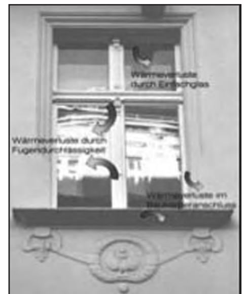
Abb. 3: Wärmeverluste am bauzeitlichen Fenster
