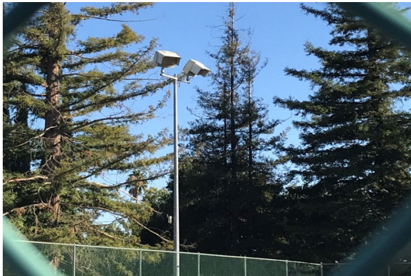
#57 G SITE POLE LIGHT
