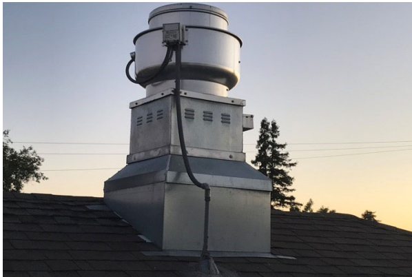
#33 D30 EXHAUST FAN
