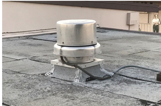
#34 D30 EXHAUST FAN
