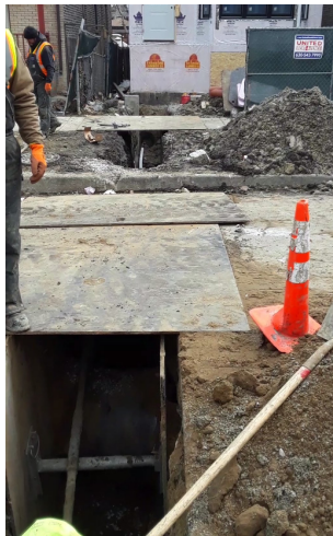
Figura ES.6.1: Instalación abierta de línea de servicio
