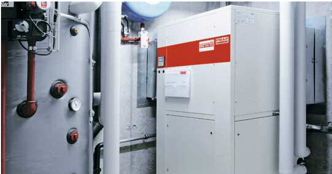
Baubewilligungsfreie Luft/Luft-Wärmepumpe mit Luftbezug im Haus
