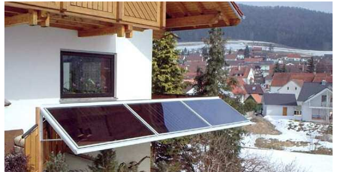
Solaranlage an Fassade
